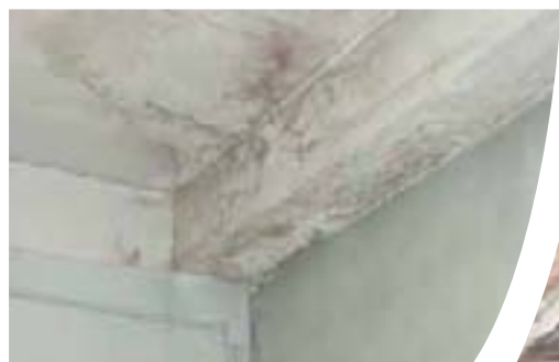
Traces d'infiltrations sur un plafond comportant des bois coffrés
