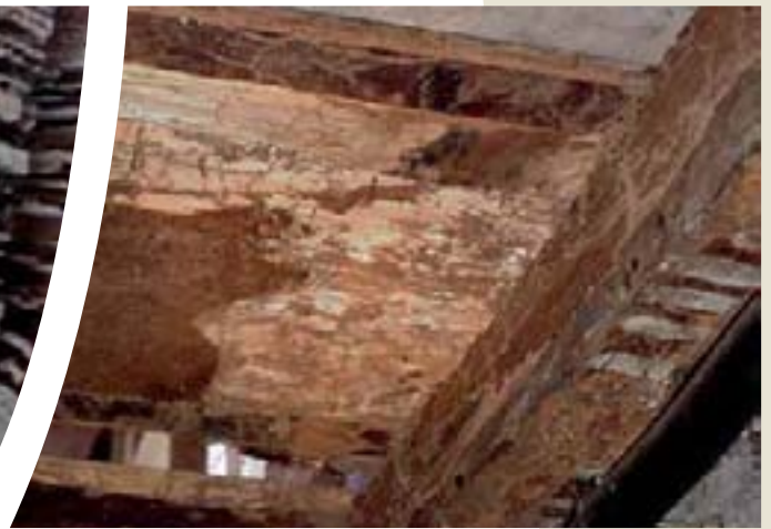
Attaques sur un solivage de plancher
